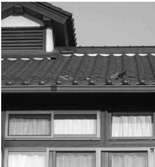
三春の里屋根瓦の破損
