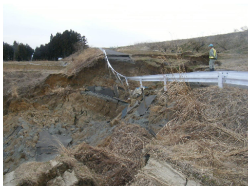
(崩落した町道西方後作線の区間)
