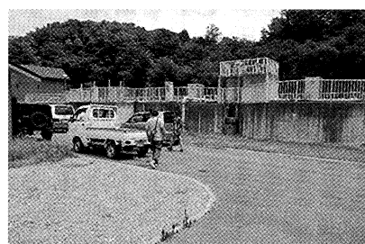
横から見た反応槽
